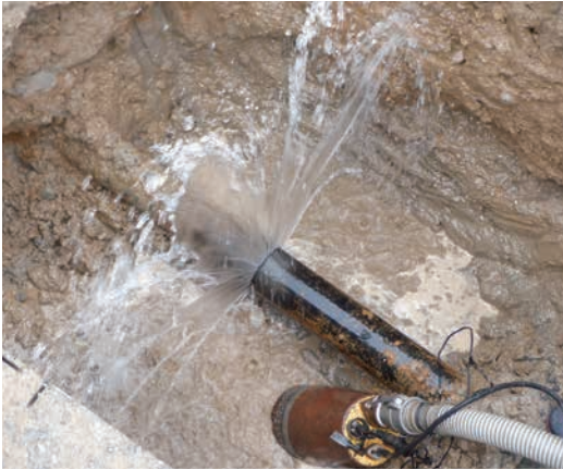
上郷北条 配水管の漏水
